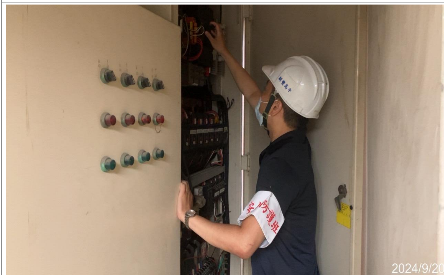
內容說明：災難發生時緊急關閉電源(安全防護班訓練)
